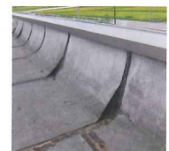
「めくれ」部分から漏水の恐れあり
