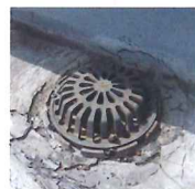
「ドレン周り」のひび割れ
