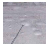
「浮き」や「ふくれ」は破裂し、そこから漏水に繋がる
